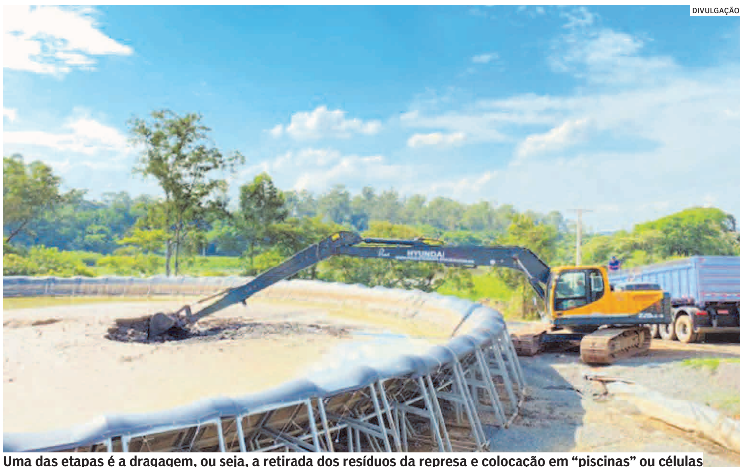
Uma das etapas é a dragagem, ou seja, a retirada dos resíduos da represa e colocação em “piscinas” ou células
