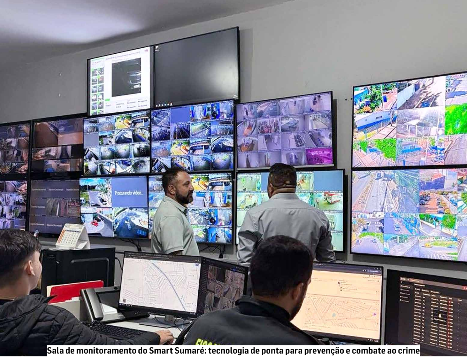
Sala de monitoramento do Smart Sumaré: tecnologia de ponta para prevenção e combate ao crime
