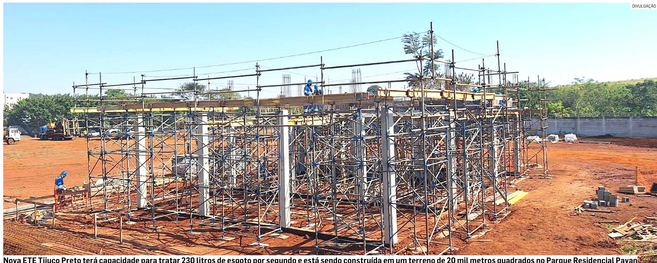
Nova ETE Tijuco Preto terá capacidade para tratar 230 litros de esgoto por segundo e está sendo construída em um terreno de 20 mil metros quadrados no Parque Residencial Pavan
