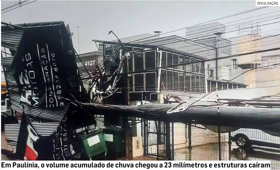
Em Paulínia, o volume acumulado de chuva chegou a 23 milímetros e estruturas caíram
