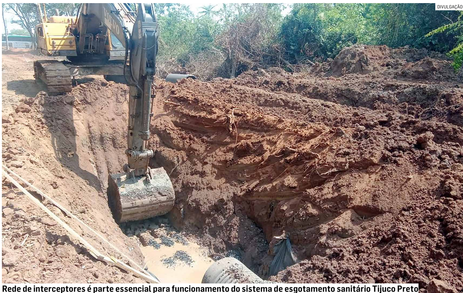
Rede de interceptores é parte essencial para funcionamento do sistema de esgotamento sanitário Tijuco Preto
